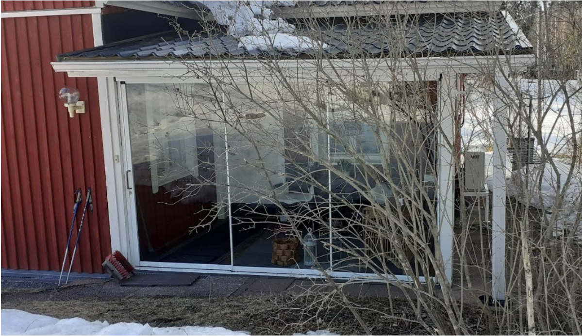
Yllä kuisti kuvattuna huhtikuussa 2022. Kuvassa näkyvät vuonna 2016 asennetut lasitukset. Kuistin koko ei muuttunut 1990-luvun alun tilanteesta.
